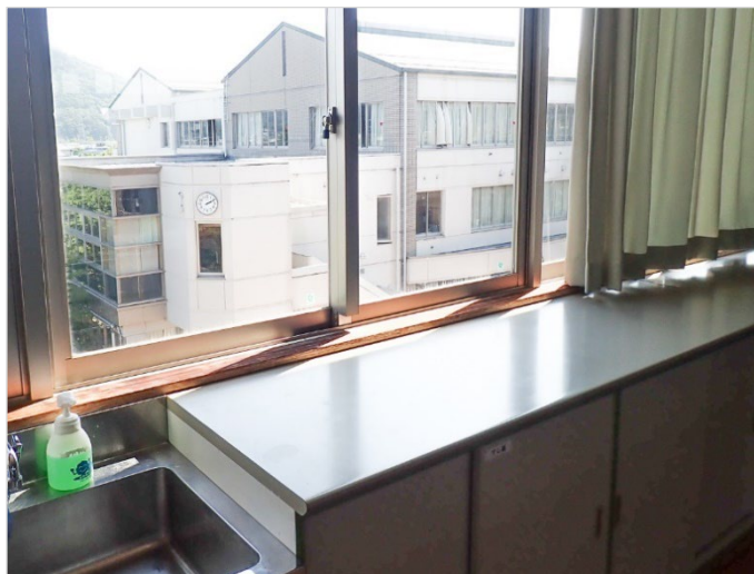
写真1 転落の危険のある窓（学校 A）
