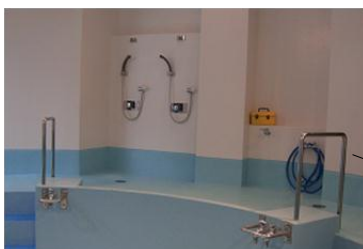
シャワー設置場所付近
