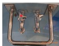
プールの蛇口
